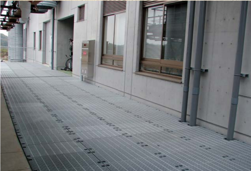
床板グレーチング
